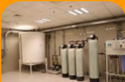
Sala de bombas de agua
